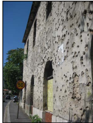
En skottskadad fasad i staden Mostar i södra BiH.
